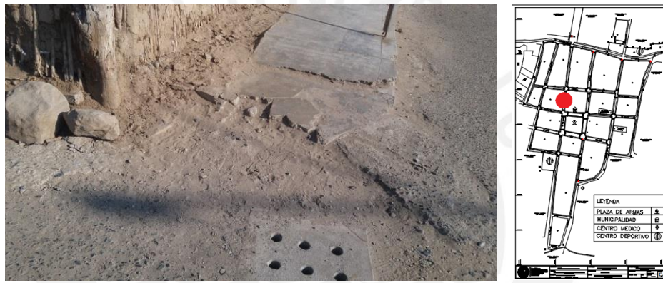
Figura 3.8: Vereda deficiente con desnivel en el medio de la calle San Pedro. Fuente: Propia
