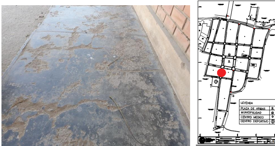
Figura 3.10: Vereda deficiente en un tramo de la calle San Pedro
