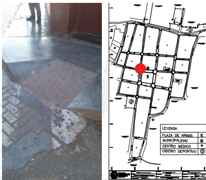
Figura 3.14: Rampa para personas con movilidad limitada en mal estado ubicada en la esquina del cruce de las calles San Jose con San Pedro.
