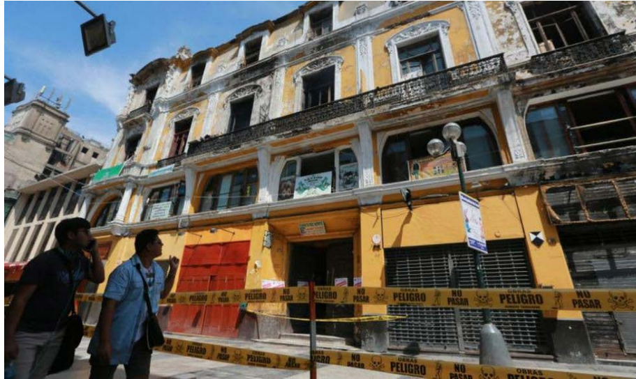
Figura 4: Casona ubicada en la cuadra 8 del Jirón de la Unión afectada por un incendio. Diario El Comercio (2017)
