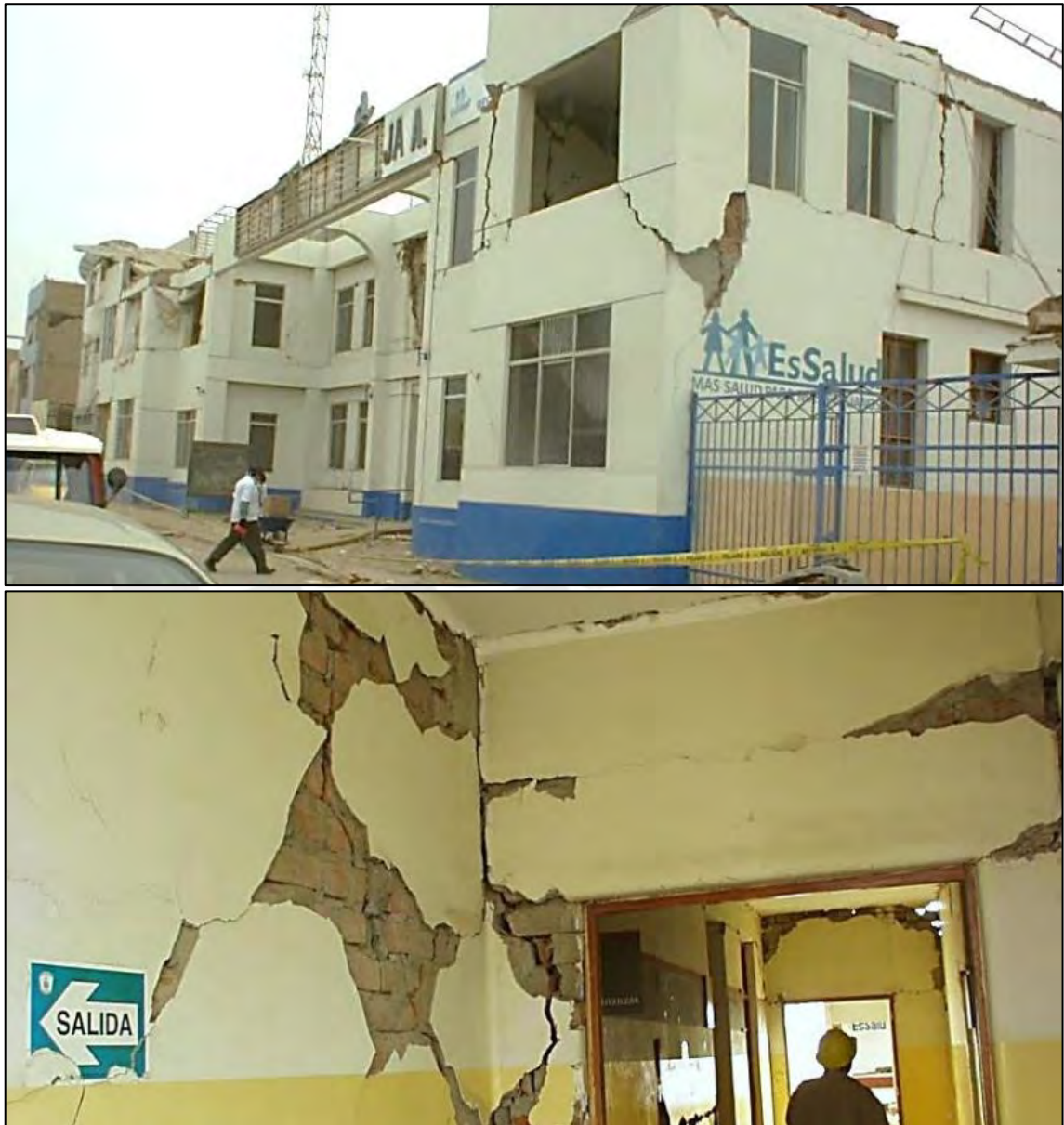
Figura 3.6.3 Daños exteriores e interiores del hospital Antonio Skrabonja de Essalud
