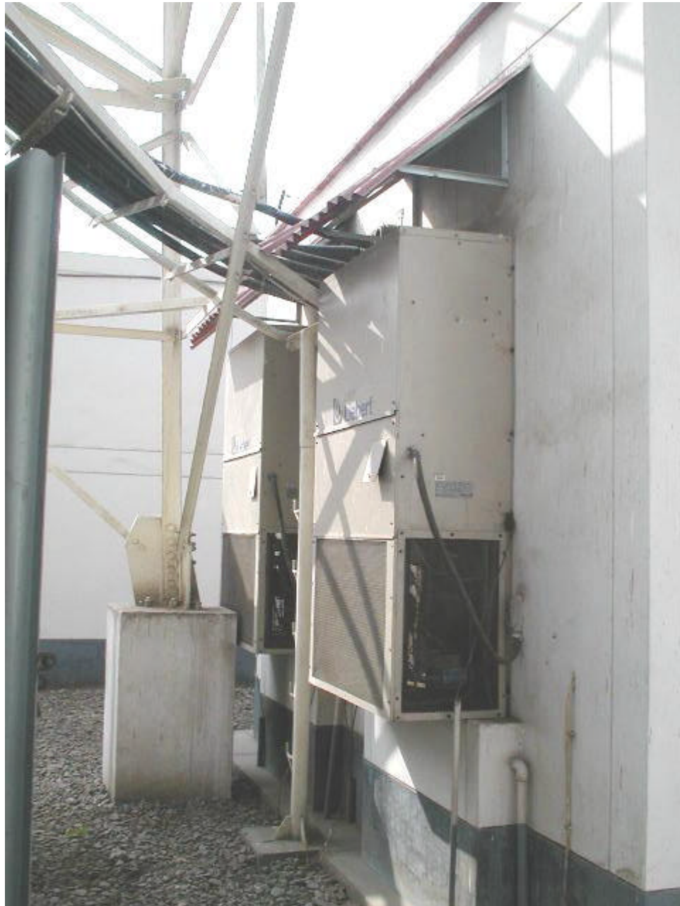
Foto 3.5 Equipos de Aire Acondicionado tipo Mochila
