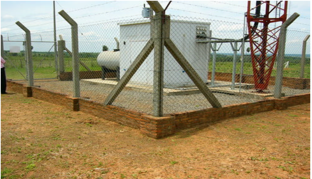
Foto 3.4 Sala para equipos
