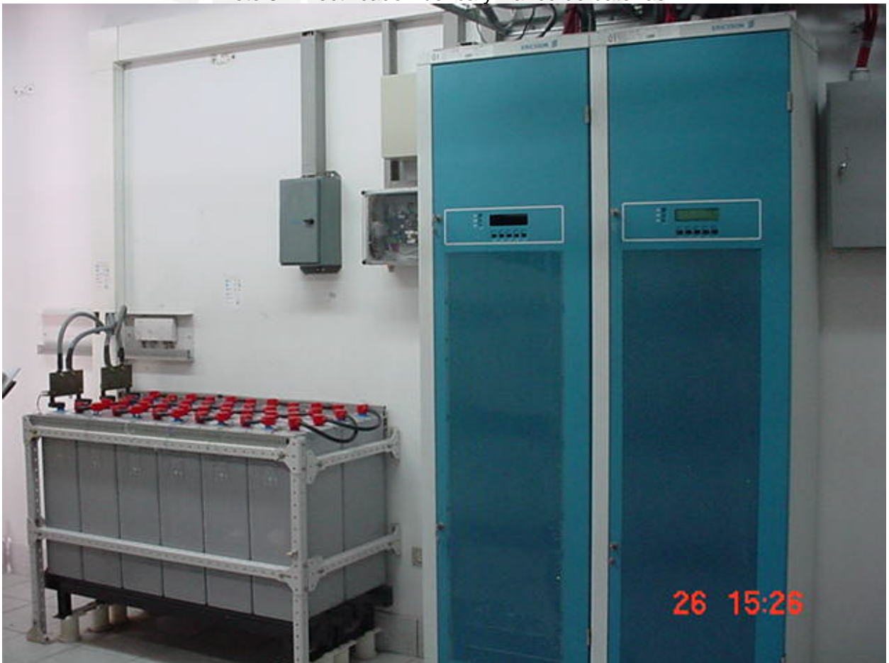
Foto 3.7 Rectificador Iberica y Banco de baterías
