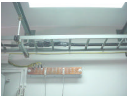
Foto 3.2 Viga y Escalerillas
