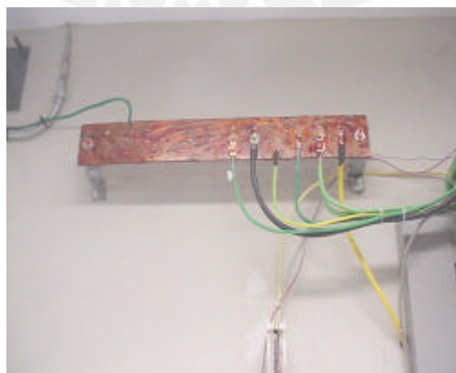
Foto 3.8 Platina de Tierra sala equipos
