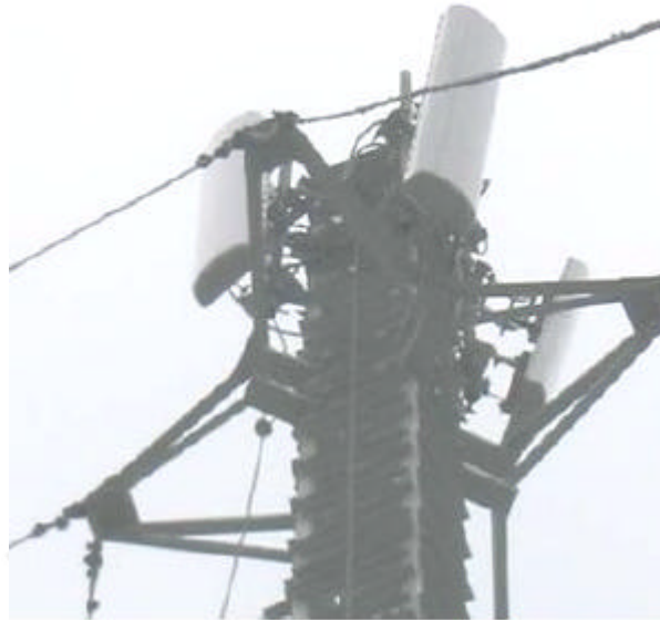
Foto 3.13 Arreglo de 3 sectores con antenas duales
