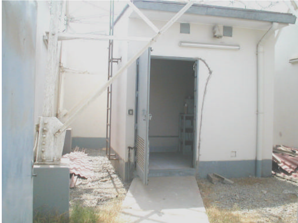
Foto 3.15 Estación Repetidor Celular
