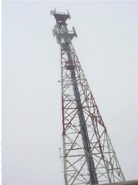
Foto 3.1 Torre Autoportada con plataforma para antenas de estación base celular.
