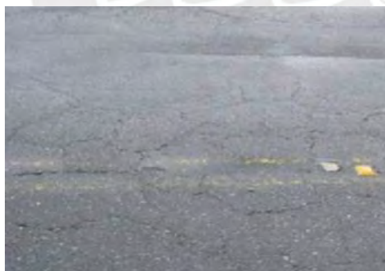
Figura 2. Fisuras en bloque.
