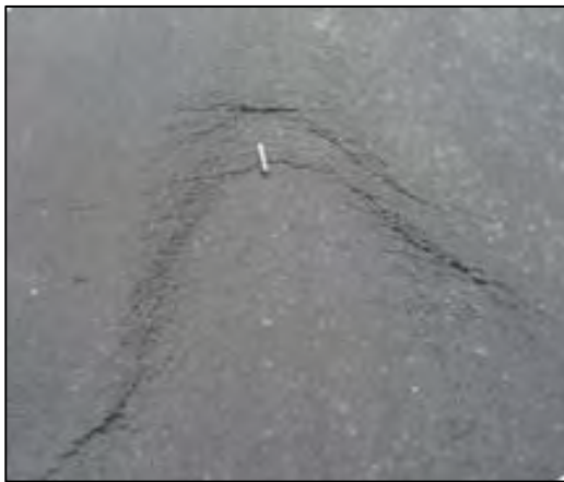
Figura 5. Fisuración por deslizamiento de capas.
