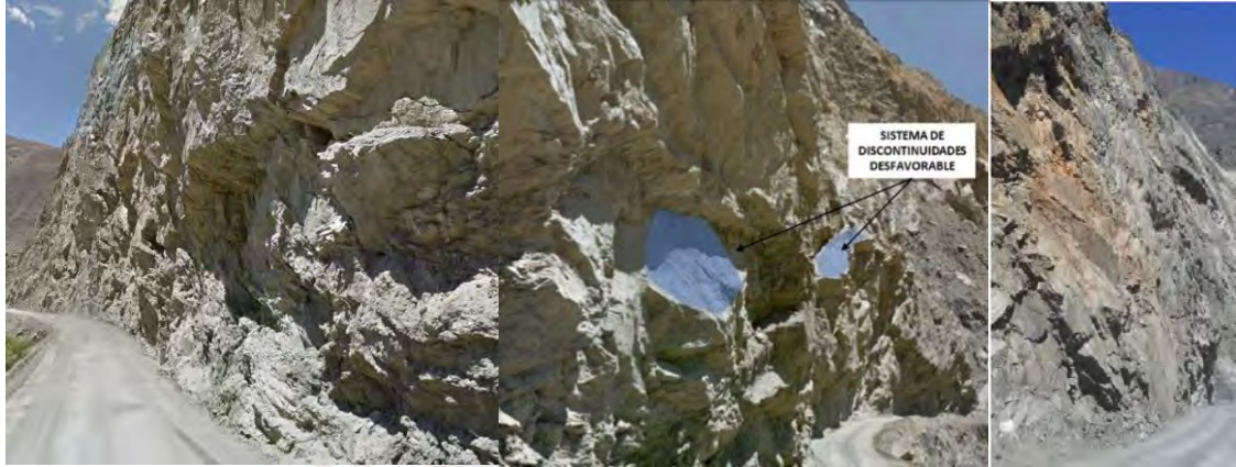
Figura 2.8. (a) Familia de discontinuidades en el talud superior, con pendiente entre 70^\circ y 78^\circ . (b) Presencia de discontinuidades locales desfavorables (Estudio geomecánico del proyecto)
