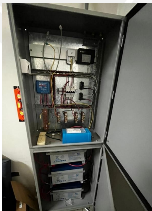
Figura 5.1: Gabinete y conexión interna de estación cliente completado.
