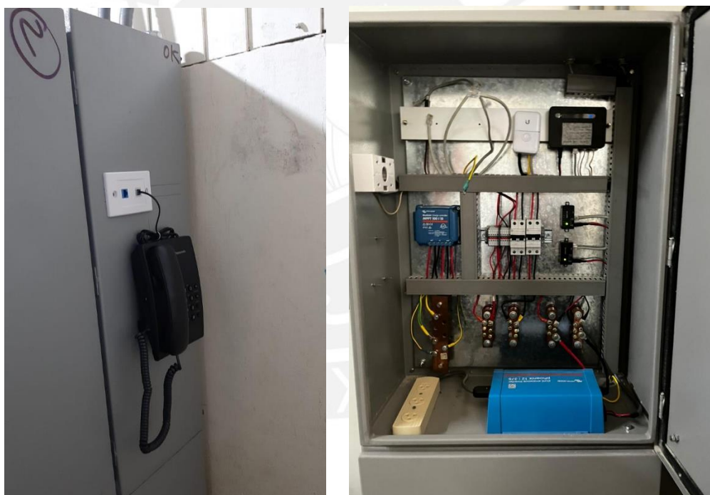
Figura 4.7: Gabinetes de estaciones clientes finalizados en fase inicial: a) Teléfono para comunicación VoIP instalado. b) Cableado interno para consumo de energía por baterías, conexión a Access Point, ATA y baterías.
