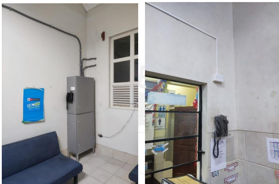
Figura 5.2: a) Gabinete de estación cliente completado junto con el teléfono VoIP. b) Conexión de teléfono VoIP ubicado hasta la sala de emergencias del HISMN.
