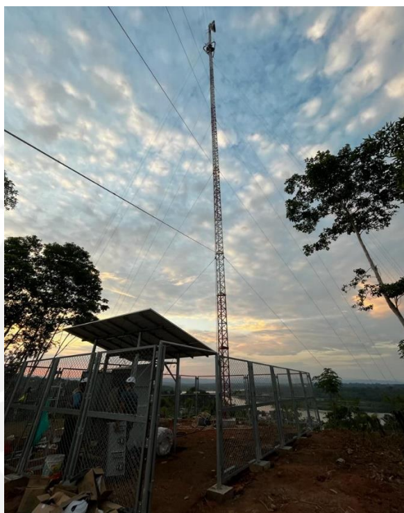
Figura 4.8: Sistema de Torre de Telecomunicación con estación servidor incluyendo gabinetes, cerco de seguridad y paneles solares ubicado en Nieva.
