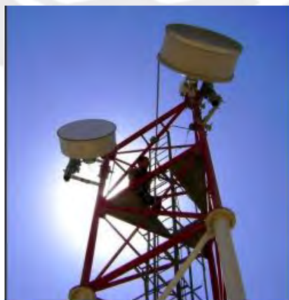
Figura 2.7 - Torre con antena de microondas. Fuente: [11]
