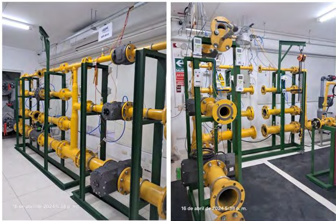
Figura 10 Dos bancos para la verificación de medidores.
