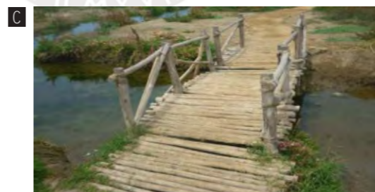
Puentes en estado de deterioro
