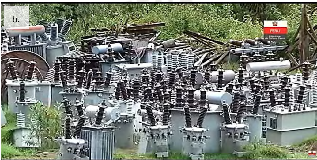
Figura 17 (a y b) Existencias (e.g., transformadores) (recuadros amarillos en a) en área colindante a la central eléctrica, 2015. Fuente: MINCUL (2015)
