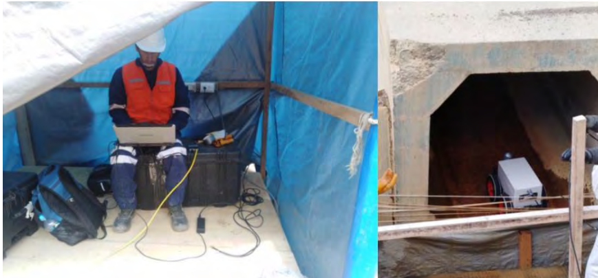
Figura 3.47 Operario en la estación de control (figura izquierda). Robot ingresando al ducto (figura derecha)
