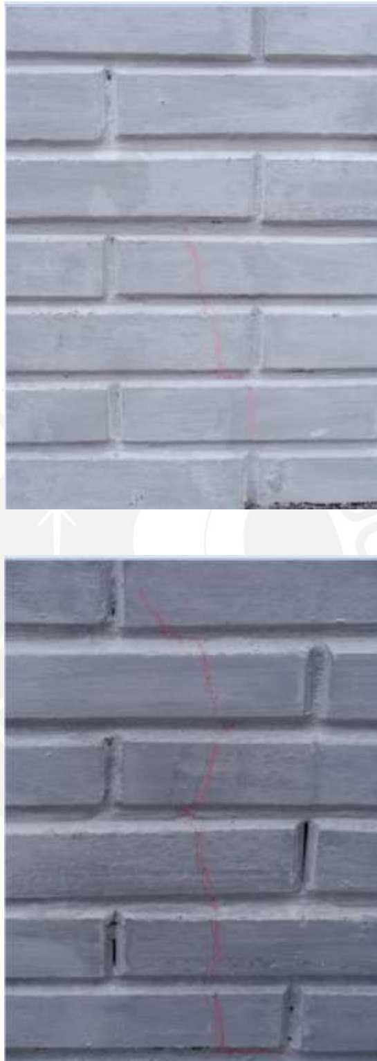
Fig.8.6 Grietas verticales en las unidades.
