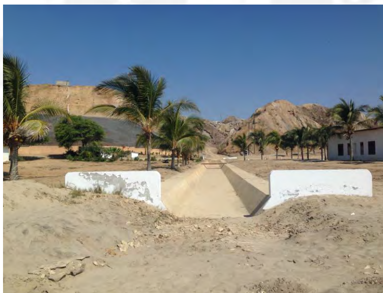
Figura 31. Canal de drenaje para efluentes de quebradas. Fuente: Fotografía tomada en salida de campo.
