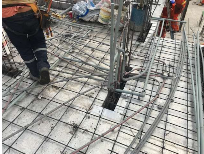
Fig. 61 – Instalaciones (Fuente propia)
