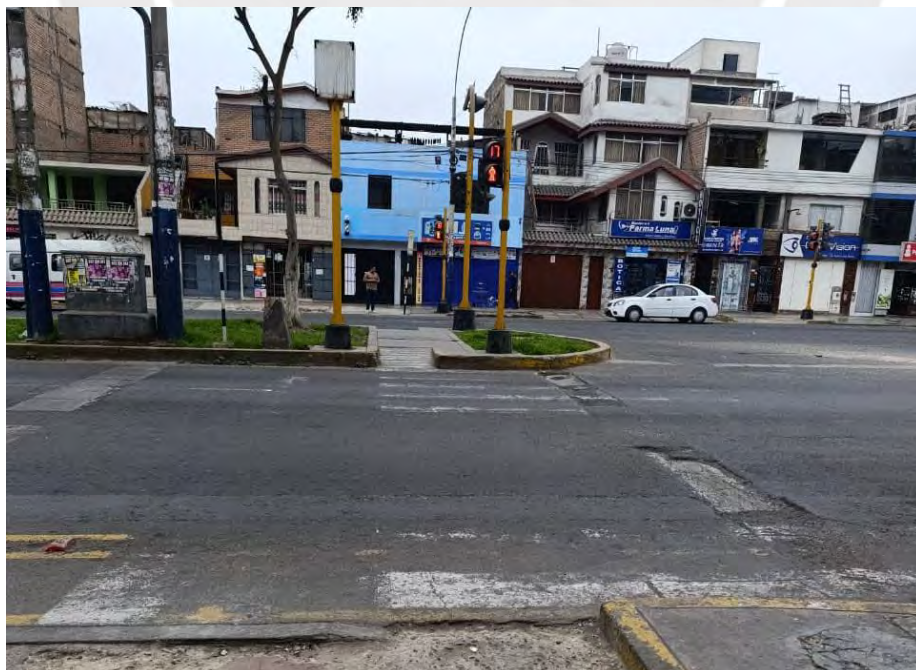
Figura 16. Señalización horizontal en mal estado. Toma fotográfica propia
