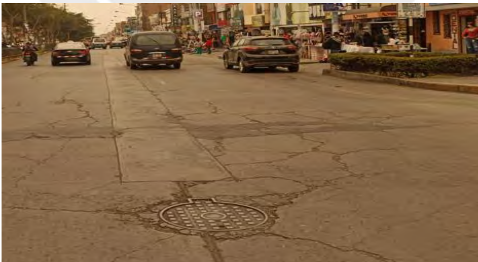
Figura 20. Agrietamiento y hundimiento de la superficie de rodadura. Toma fotográfica propia.
