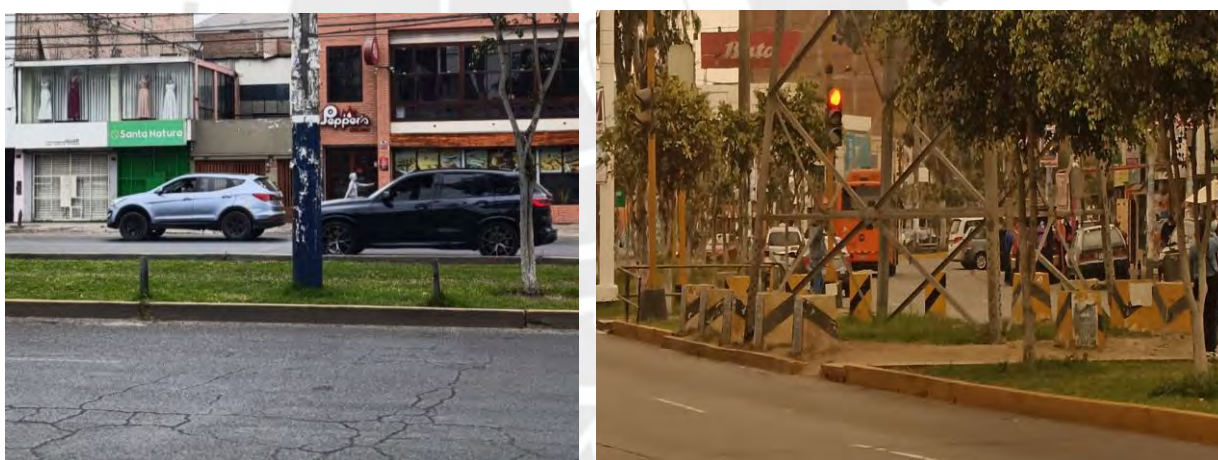
Figura 24 y 25. Barrera de contención desaparecida (izquierda) y bloques de concreto resguardando base de torre de alta tensión (derecha). Toma fotográfica propia
