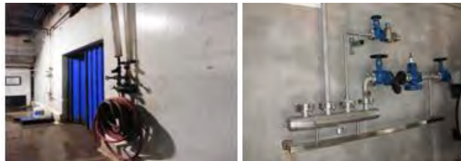
Figura 56: Línea de vapor para limpieza y desinfección
