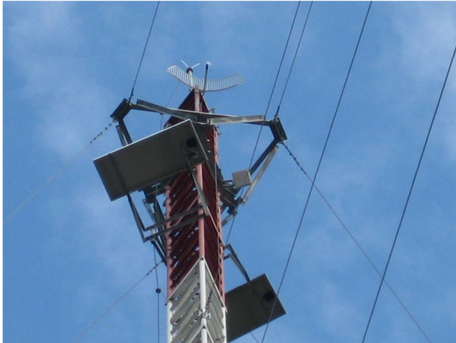
Gráfico 43: Vista de los equipos instalados en lo alto de la torre de 72m
