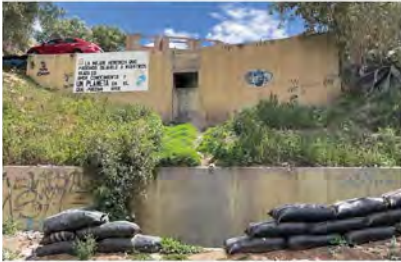
Drenaje improvisado que continua la canaleta anterior ②
