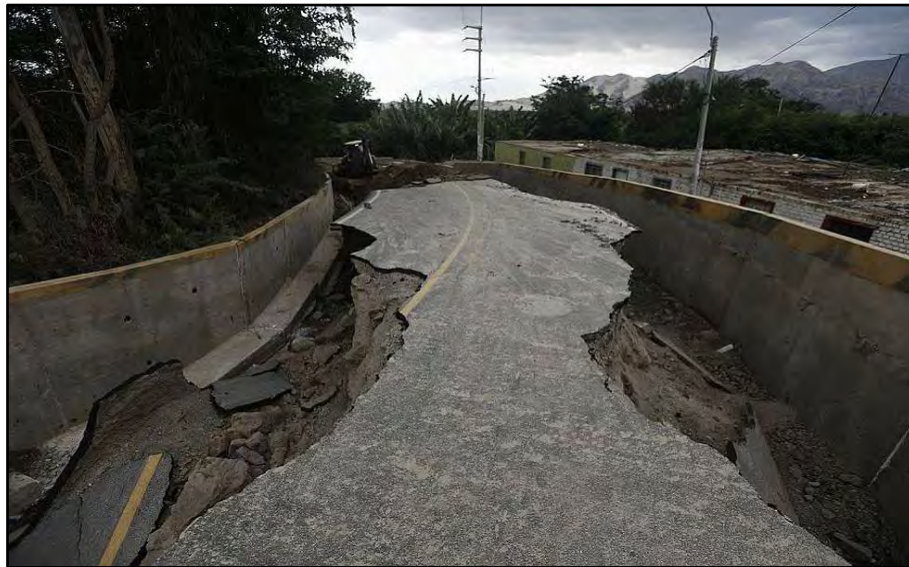
Figura 21. Daño longitudinal en carreteras por inundaciones
