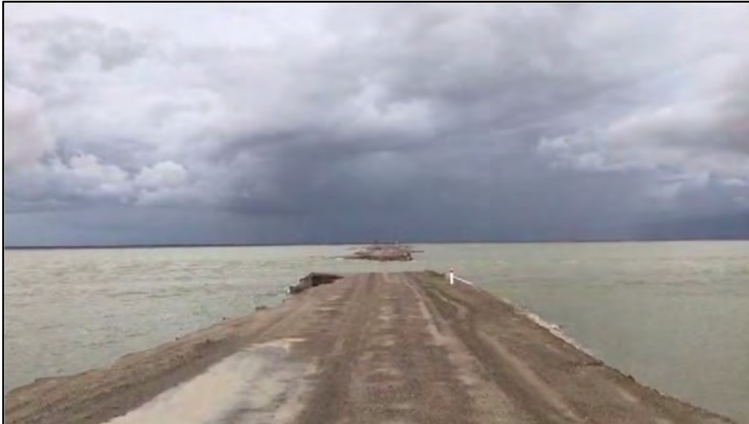
Figura 12. Tramo Chiclayo-Bayóvar posterior al daño con afectación transversal
