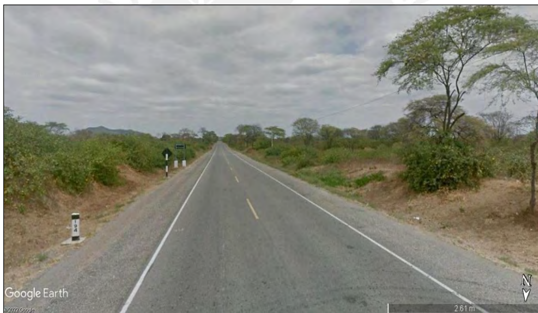
Figura 8. km 66-Piura-Olmos previo al daño
