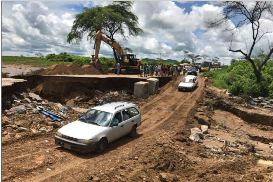
Figura 9. km 66 Piura-Olmos posterior al daño
