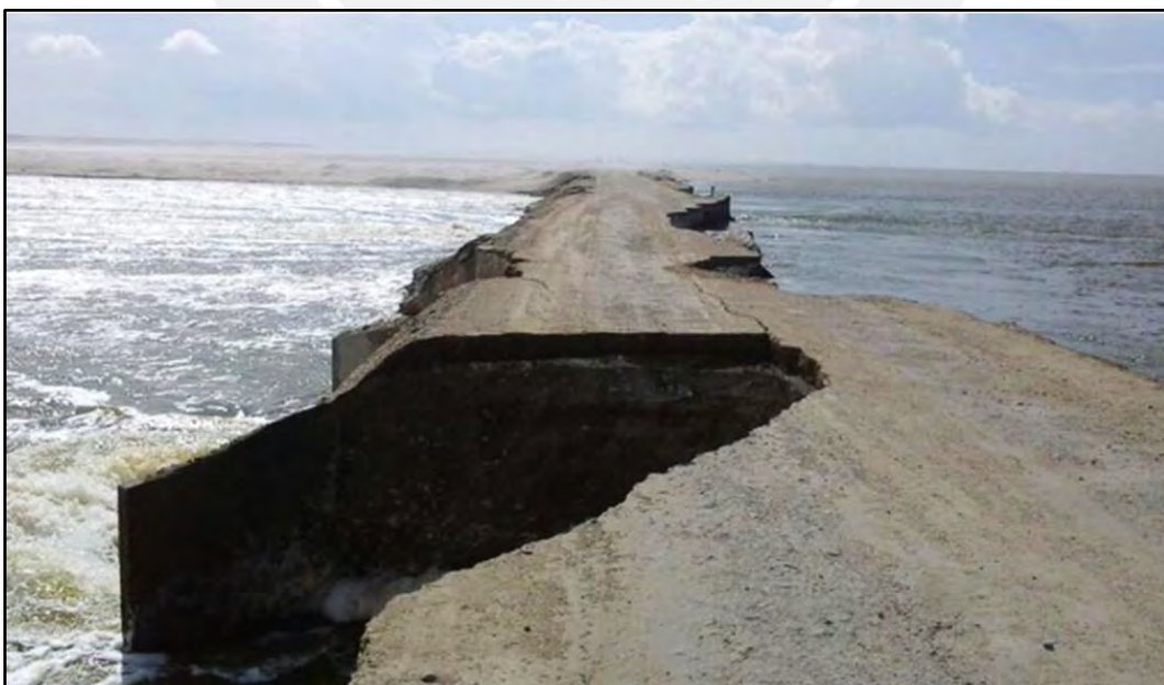
Figura 13. Tramo Chiclayo-Bayóvar posterior al daño con afectación longitudinal
