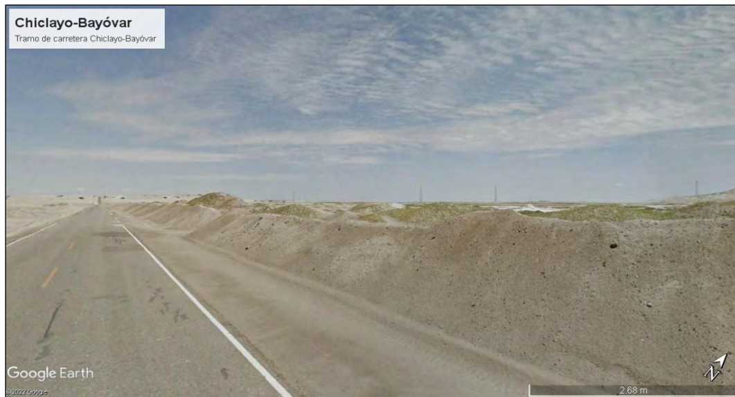
Figura 10. Tramo Chiclayo – Bayóvar previo al daño
