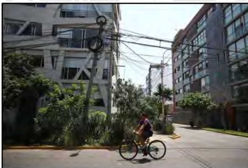
Foto: Cerdán J. (2024). Poste inclinado en el cruce de las calles Francia y Ramón Zavala en Miraflores [Fotografía]. El Comercio. https://elcomercio.pe/lima/empresas-de-telefonía-y-electricidad-deberan-retirar-cables-en-desuso-quienes-las-supervisaran-fotos-cableado-aereo-maranas-noticias-movistar-noticia/
