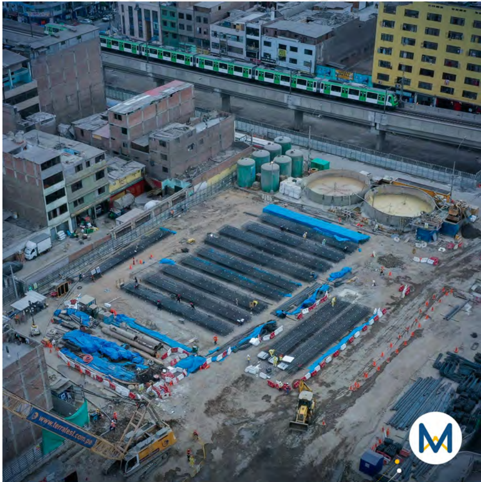
Figura 6: Toma aérea de inicio de obras en la estación 28 de julio Fuente: Línea 2 del Metro de Lima y Callao, (2023)
