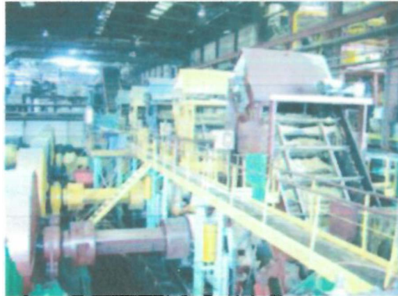
Figura N° 1.3: Tándem de molinos de la empresa analizada
