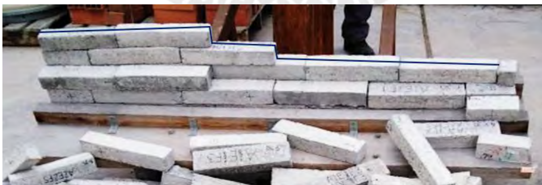
Figura 5.14 Vista frontal de A2V2 (P1) (la línea azul delinea el borde del muro después del colapso)
