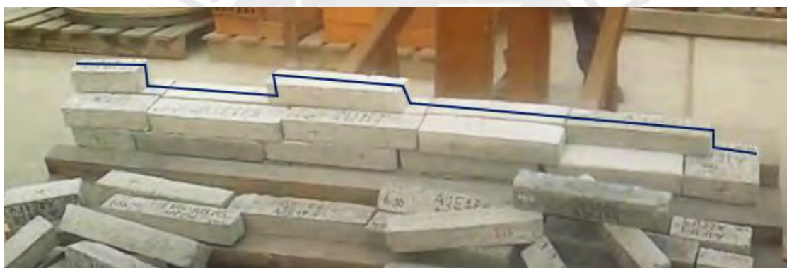
Figura 5.13 Vista frontal de A2V1 (P1) (la línea azul delinea el borde del muro después del colapso)
