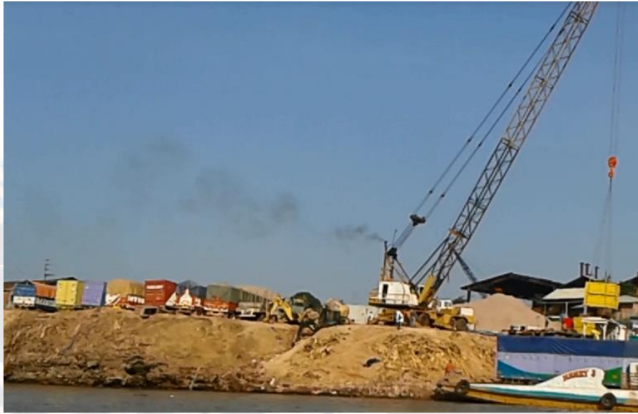
Figura 17. Ribera de un embarcadero informal relleno con desechos de aserradero y grúa móvil tipo de castillo de 20 toneladas de maniobra.
