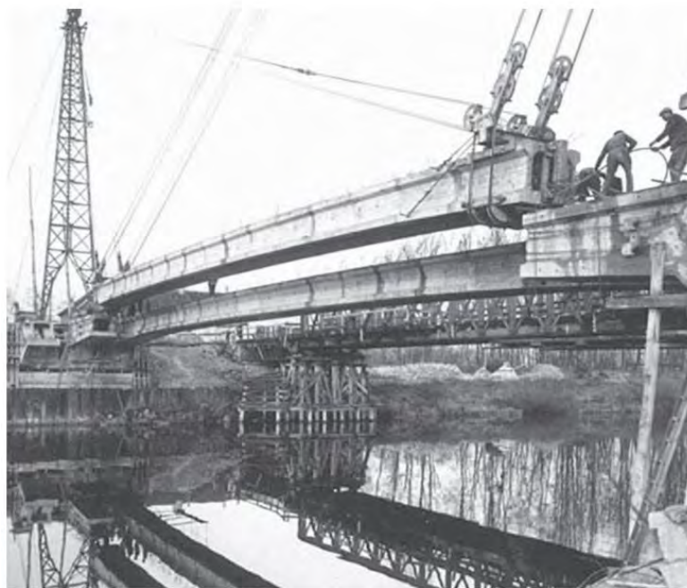
Figura 2: Montaje de vigas prefabricadas en el puente para la presa “Pontes de Fer”
