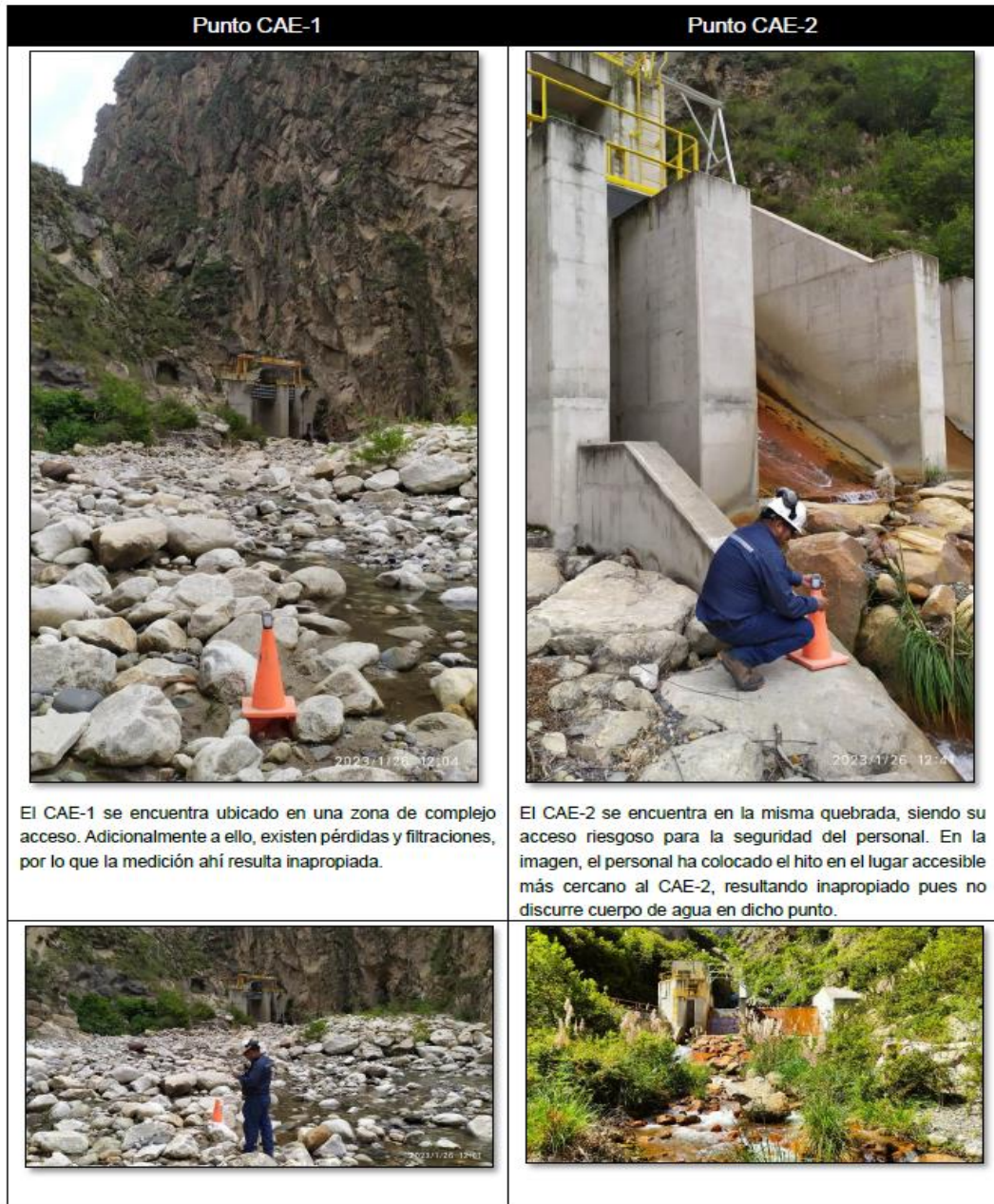
Gráfico N° 2: Fotografías en la que se evidenciaría el riesgo en la seguridad de las personas
