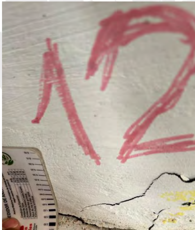
Figura 5.19. Fase 12 – Grieta de 2.5 mm
