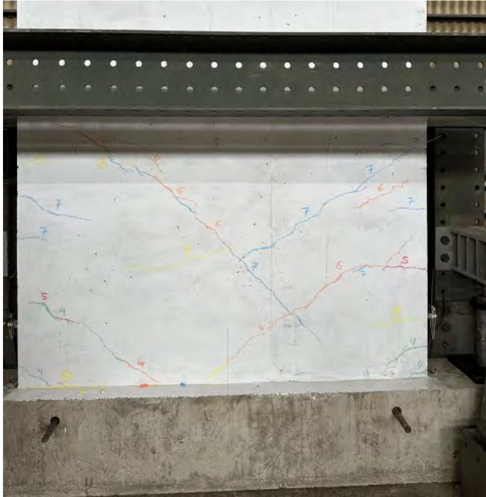
Figura 5.13. Fase 07 (Fisuras de 0.30 mm de espesor) – Amplitud 4.70 mm
