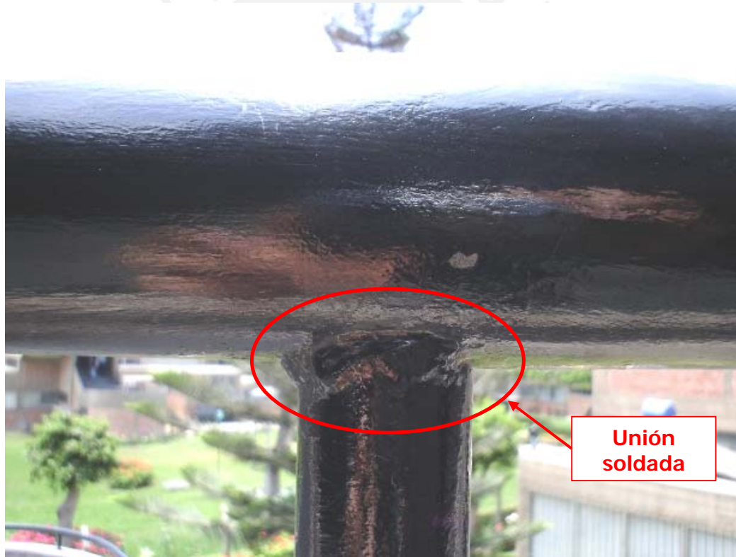
Figura 1. Unión soldada del pasamanos del segundo piso de la sección Ingeniería Mecánica.
