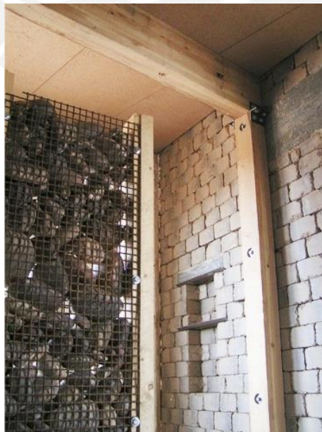
Figura 19: Muro de piedras Fuente: CEMAER (Ref. 12)
