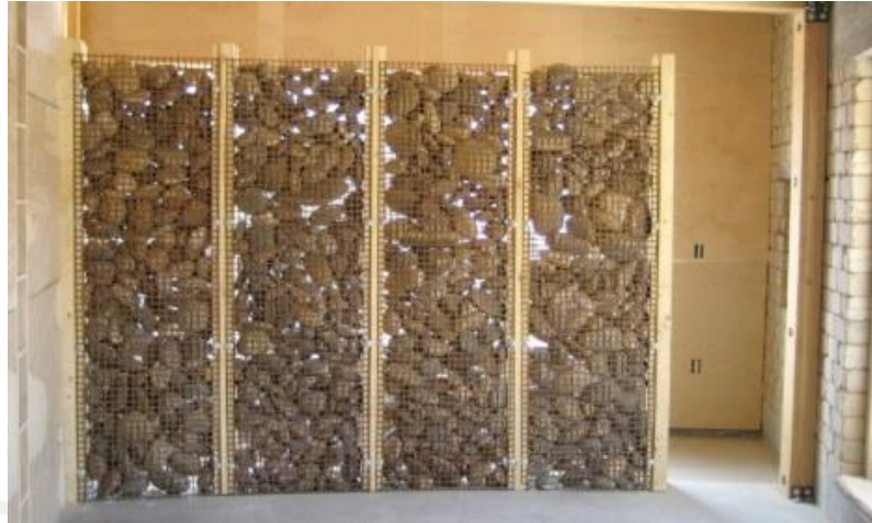
Figura 18: Muro de piedras Fuente: CEMAER (Ref. 12)
