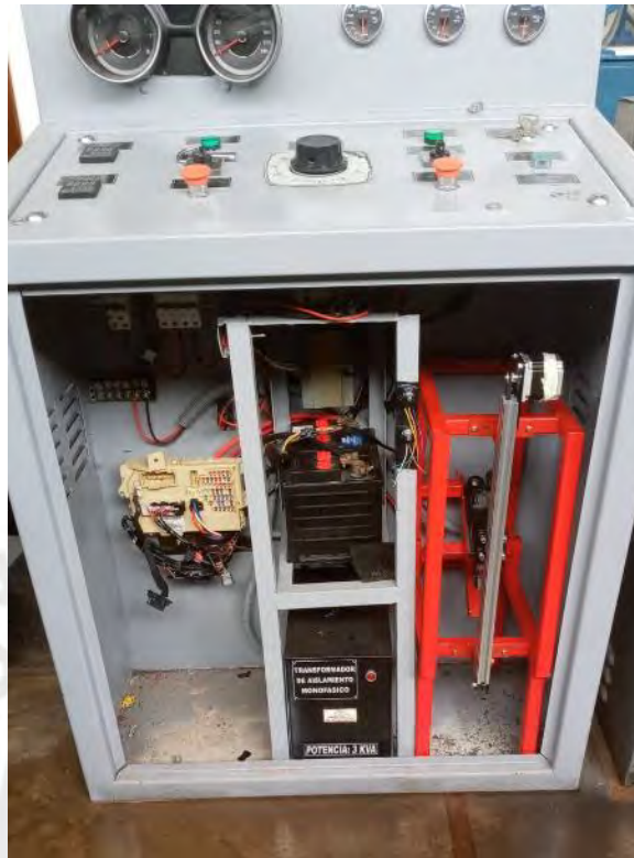
Figura 36 - Soporte instalado en el panel de control, con actuador lineal instalado (incluido motor NEMA 23).
