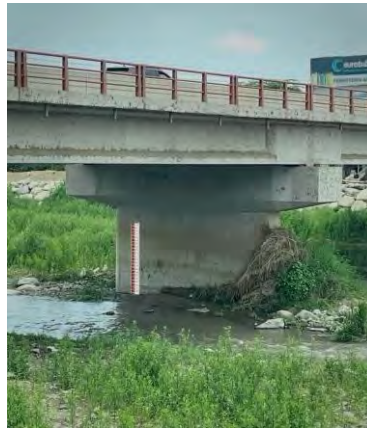
Figura 74. Marca de agua dejada por el cauce en el pilar del puente. Elaboración propia.
