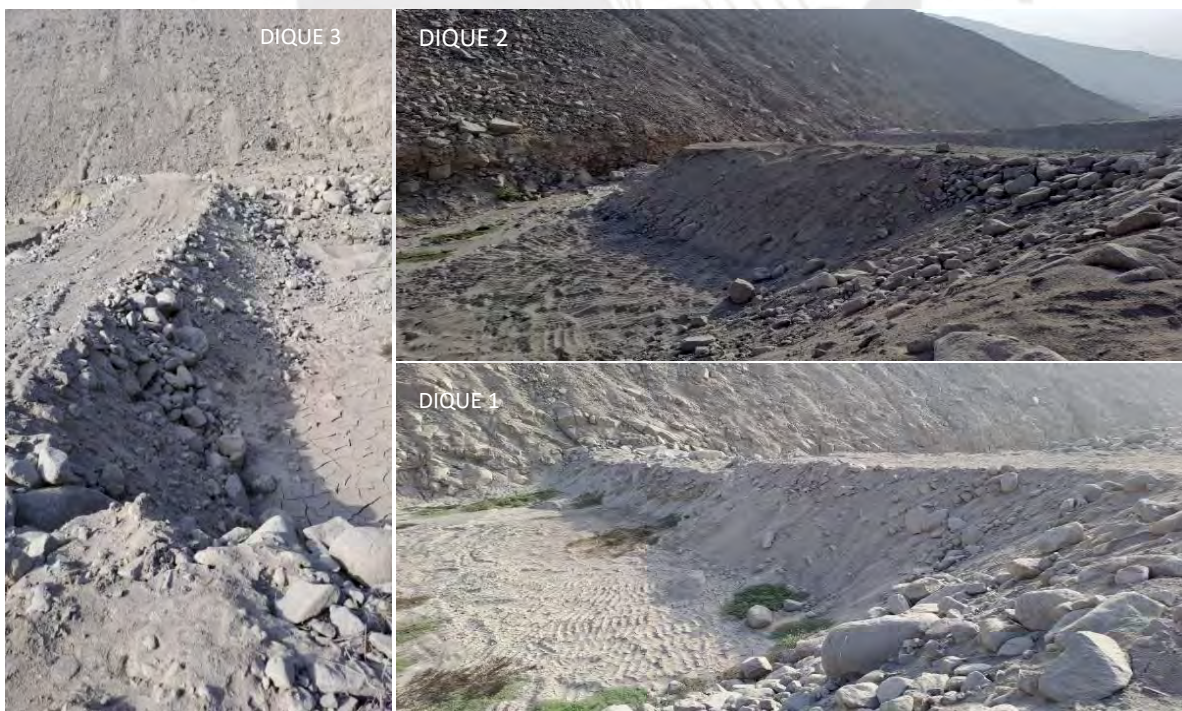
Figura 14. Fotografías de los diques existentes en el área de estudio sin reforzamiento
