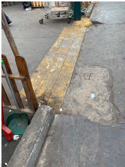
Figura 60 Estado de las veredas de la cuadra 7
