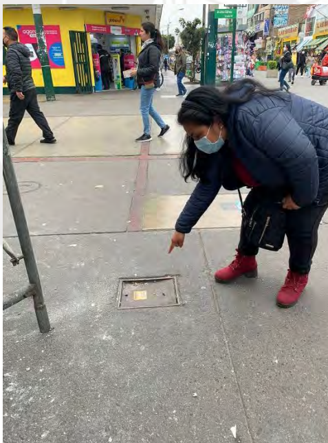
Imagen 4 Fotos obtenidas de seguimiento de problemas de la calle peatonalizada: zona que puede provocar una caída
