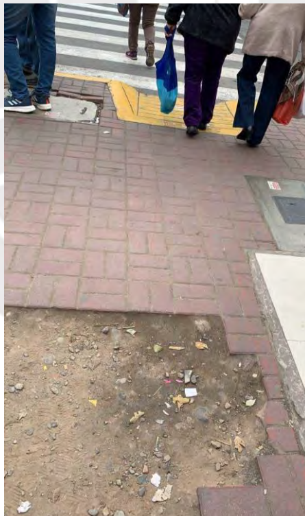
Imagen 2 Fotos obtenidas de trabajo de campo, se observa que falta realizar mantenimiento en la vereda produciendo para algunos un impedimento para transitar.
