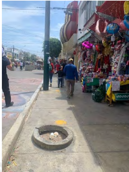
Imagen 1 Fotos obtenidas de trabajo de campo, se observa que sacaron la vegetación y genera un impedimento para transitar
