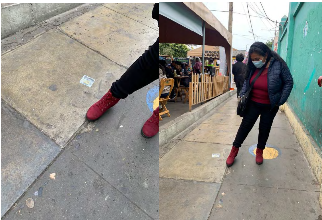
Imagen 5 Fotos obtenidas de seguimiento de problemas de la calle peatonalizada: Vereda con irregularidades
