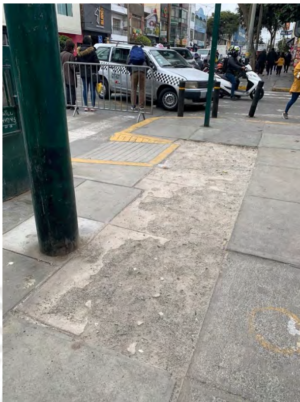
Imagen 1 Fotos obtenidas de seguimiento de problemas de la calle peatonalizada: Vereda en mal estado
