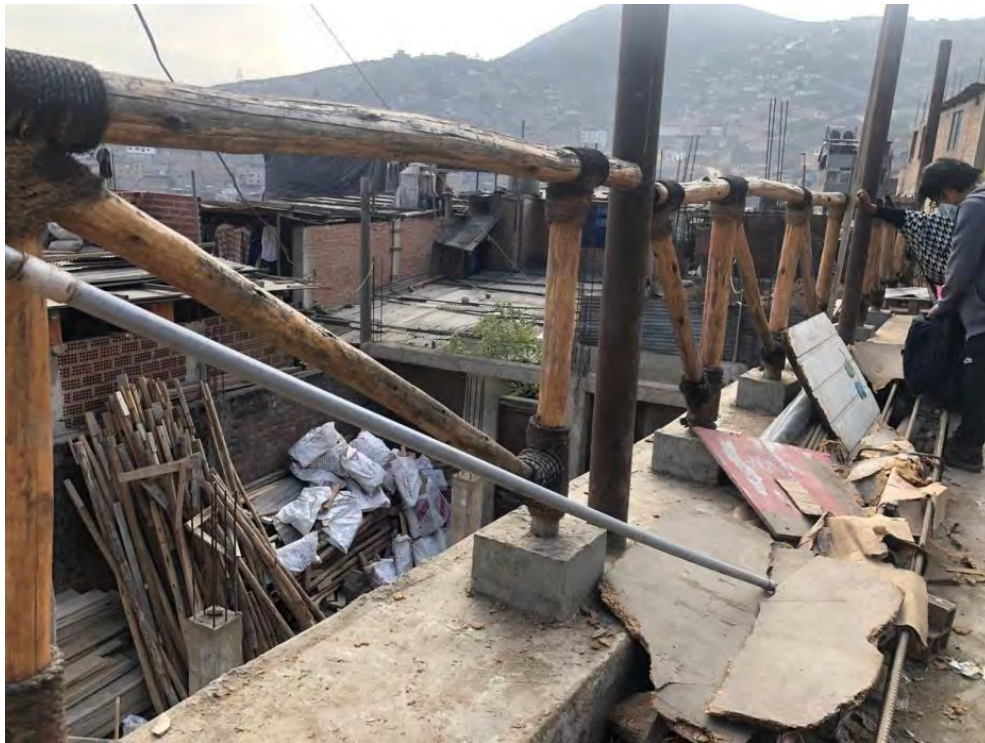
Figura 10 Baranda provisional hecha por la población en zona de riesgo y de uso intensivo
