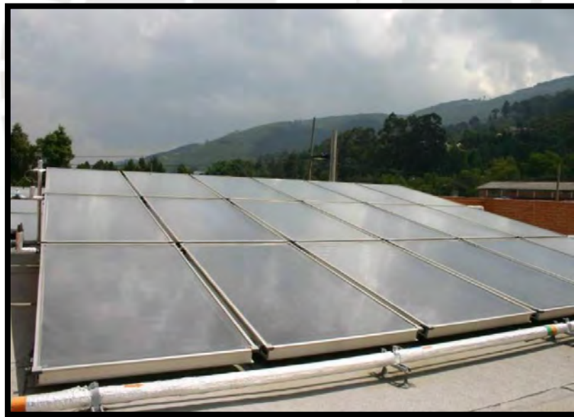
Figura 7: Sistema de paneles solares para la calefacción de duchas
