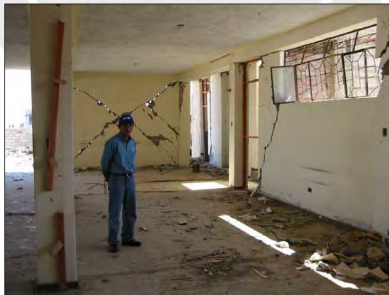
Figura 2.15: Muros de albañilería confinada con daños por corte sismo 2001 – Tacna - Perú (Hammer et al., 2001)
