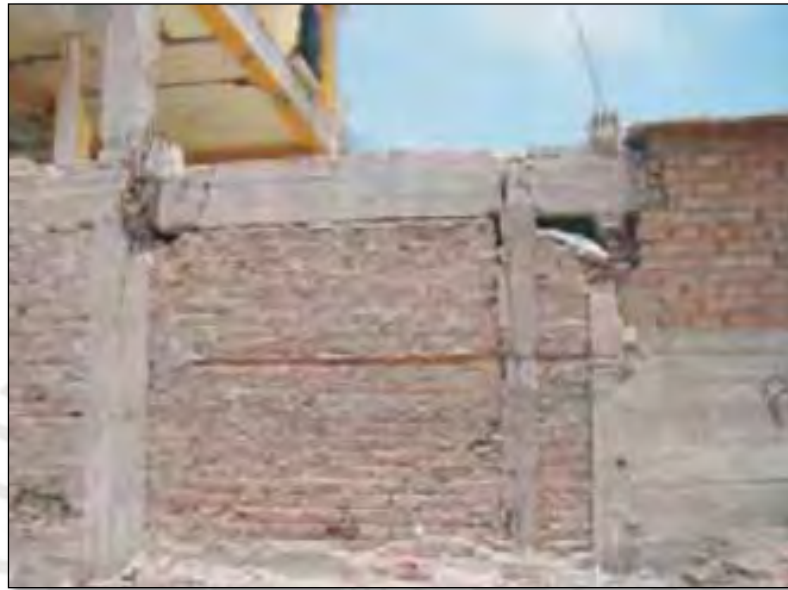
Figura 2.14: Muro dañado de albañilería confinada por el terremoto del 2007 en Pisco - Perú (PNUD, 2009)
