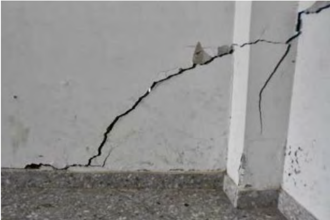
Figura 2.19. Grieta por asiento diferencial. Fuente: https://reformacoruna.com/grieta-asiento-diferencial-edificio/
