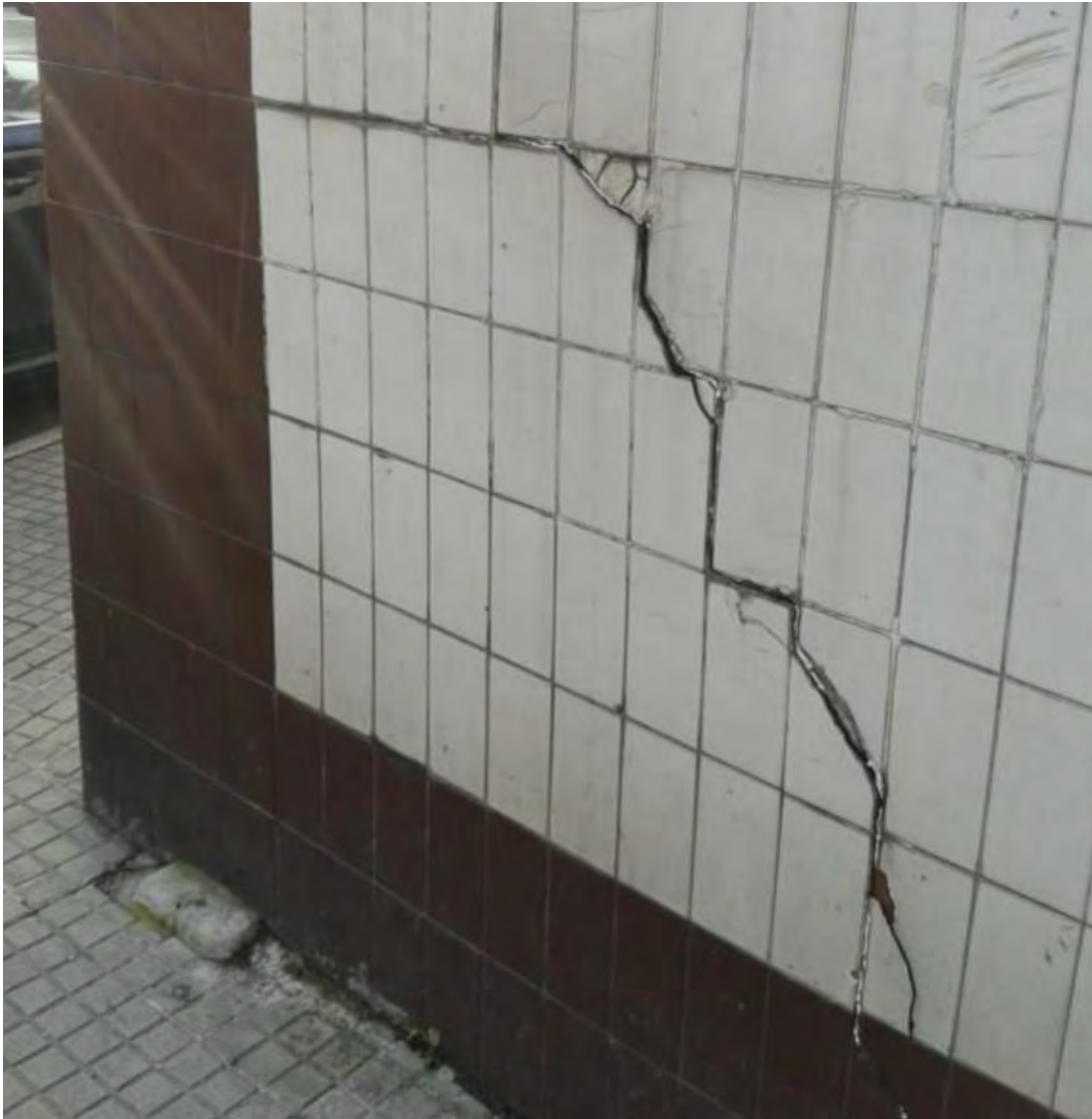
Figura 2.18. Grieta por asiento diferencial. Fuente: https://reformacoruna.com/grieta-asiento-diferencial-edificio/
