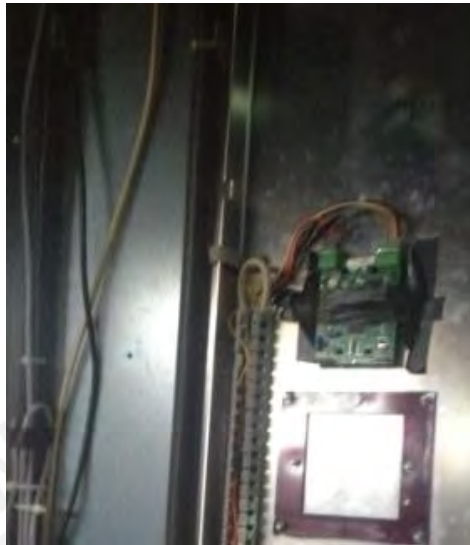
Figura 4.11.- Cableado en cabina para pruebas de comunicación CAN. Fuente: Propia
