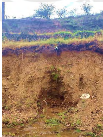
Foto 7.3 Tubería expuesta en la pendiente
