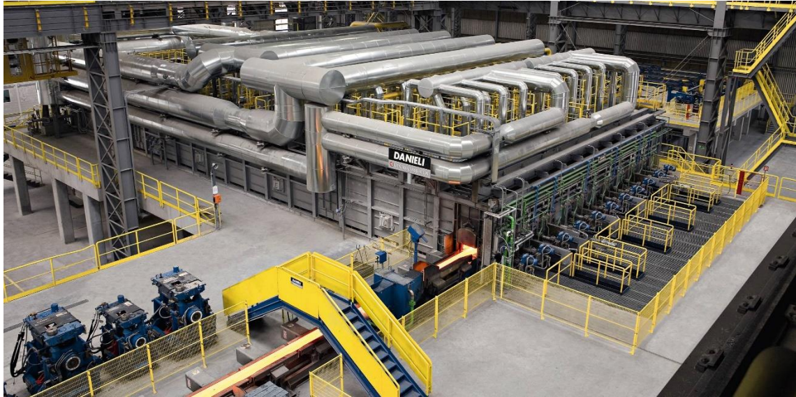
Ilustración 26. Horno de recalentamiento diseñado por Danieli en un tren de laminación. Fuente: (DANIELI , 2019)
