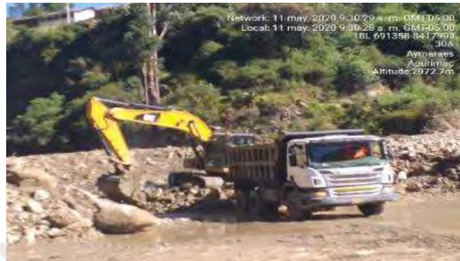
Emergencia Vial Sector 4: Km 339+250
