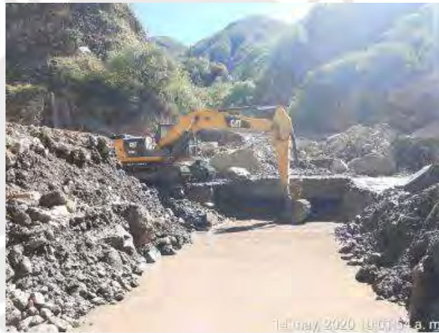
Emergencia Vial Sector 5: Km 367+900
