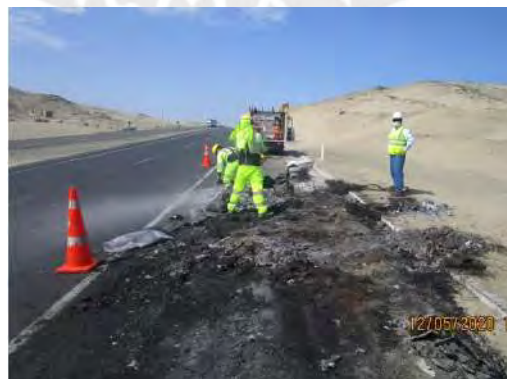
Km 403+600 Actividades de limpieza de calzada y berma por accidente de tránsito
