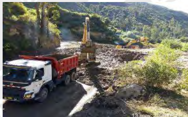
Emergencia Vial Sector 4: Km 339+250
