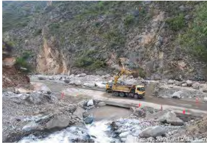
Emergencia Vial Sector 5: Km 367+900
