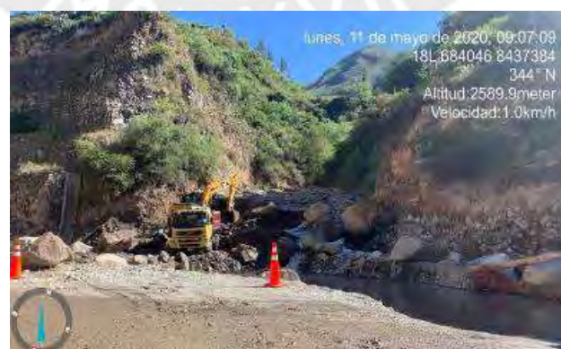
Emergencia Vial Sector 5: Km 367+900
