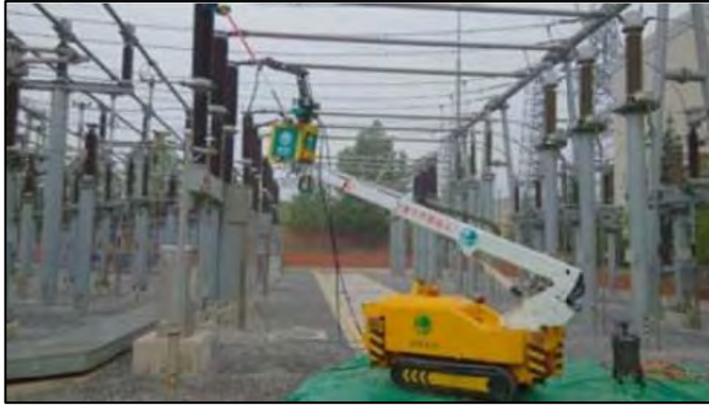
Figura 2.4 Manipulador robótico operando en subestaciones eléctricas. Huang, Zhang, Huang, & Wang, 2016.
