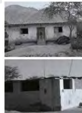
[1] VIVIENDAS EN MAL ESTADO ADOBE, QUINCHA]
