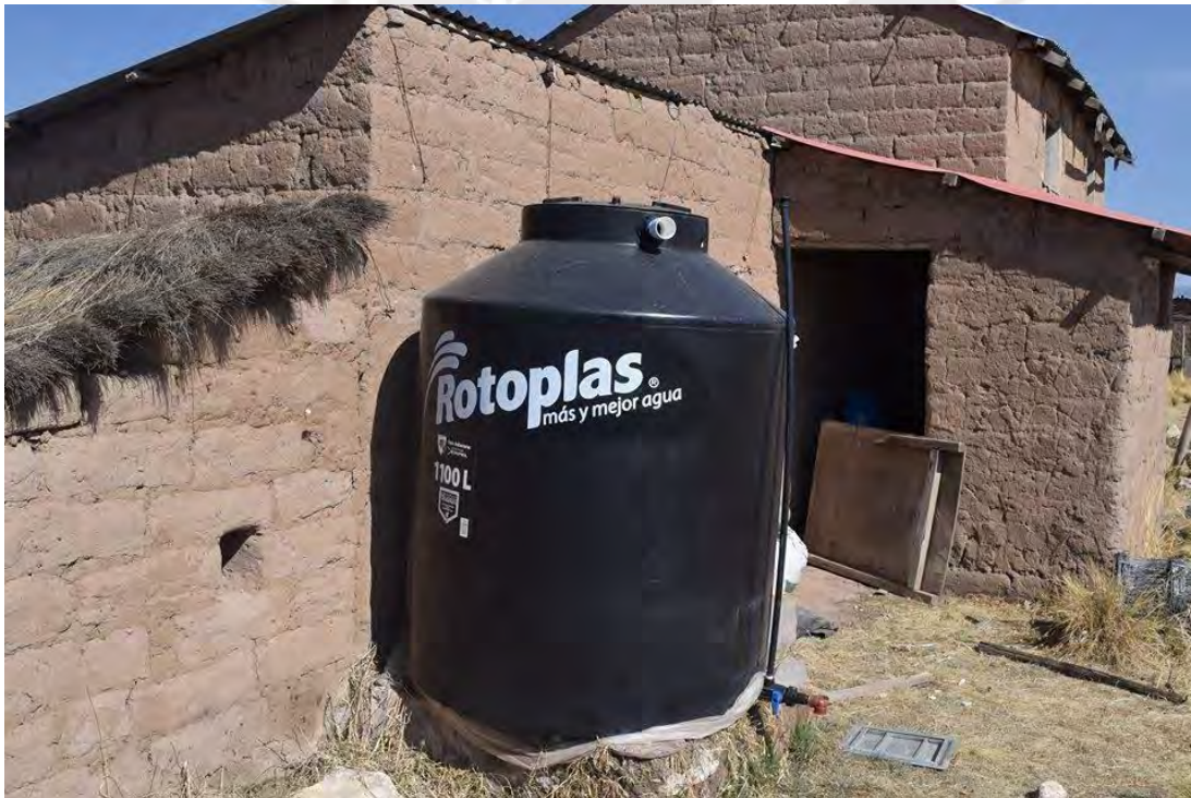
Figura 8: Rotoplas instalado en una de las casas de la CC. Huisa
