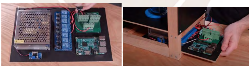
Figura 6: Panel de componentes eléctricos en el proyecto Smart Bartender
