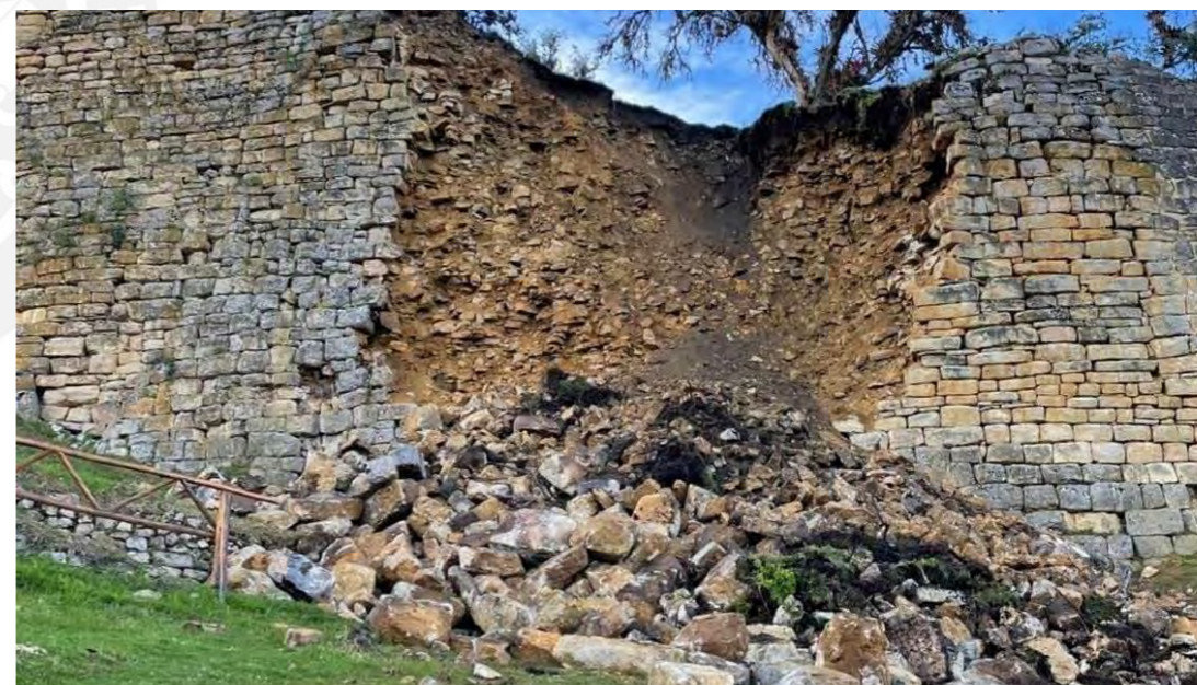
Fotografía 33: Desprendimiento de una parte del muro de la fortaleza de Kuélap, Amazonas. Fuente: SqalaTV, 2022.
