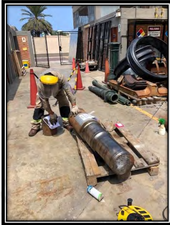
Figura 2. 34. Limpieza del eje fracturado
