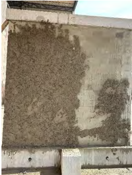
Figura 7.8: Aplicación de mortero para el pañeteo del muro en la cara posterior
