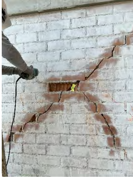
Figura 7.2: Proceso de apertura de grietas críticas superiores a 0.8 mm
