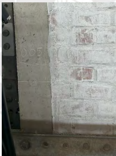
Figura 9.9: Primera fisura en tracción por flexión en el M1-CA
