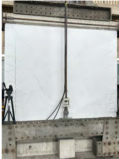
Figura 9.13: Estado final del muro M1-RR-CA sin agrietamiento diagonal significativo
