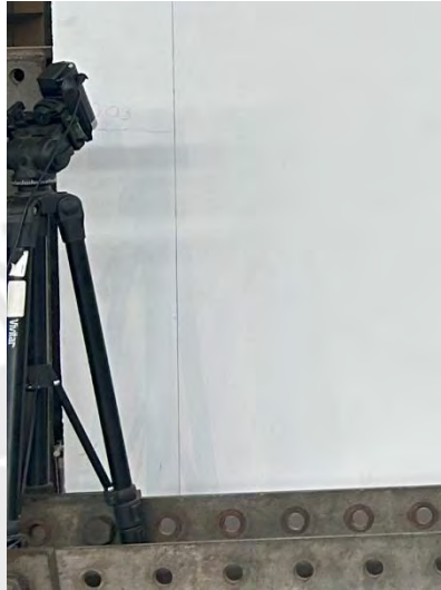
Figura 9.10: Primera fisura por tracción por flexión en el muro M1-RR-CA
