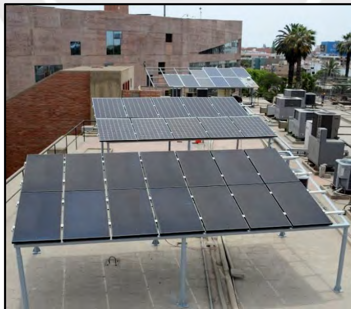
Figura N°31. Paneles fotovoltaicos instalados en la azotea de la Facultad de Física - PUCP
