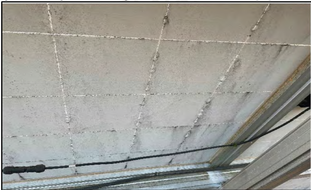
Figura N°26. Lámina protectora del panel trasero agrietada después de ocho años de funcionamiento[37], [60]
